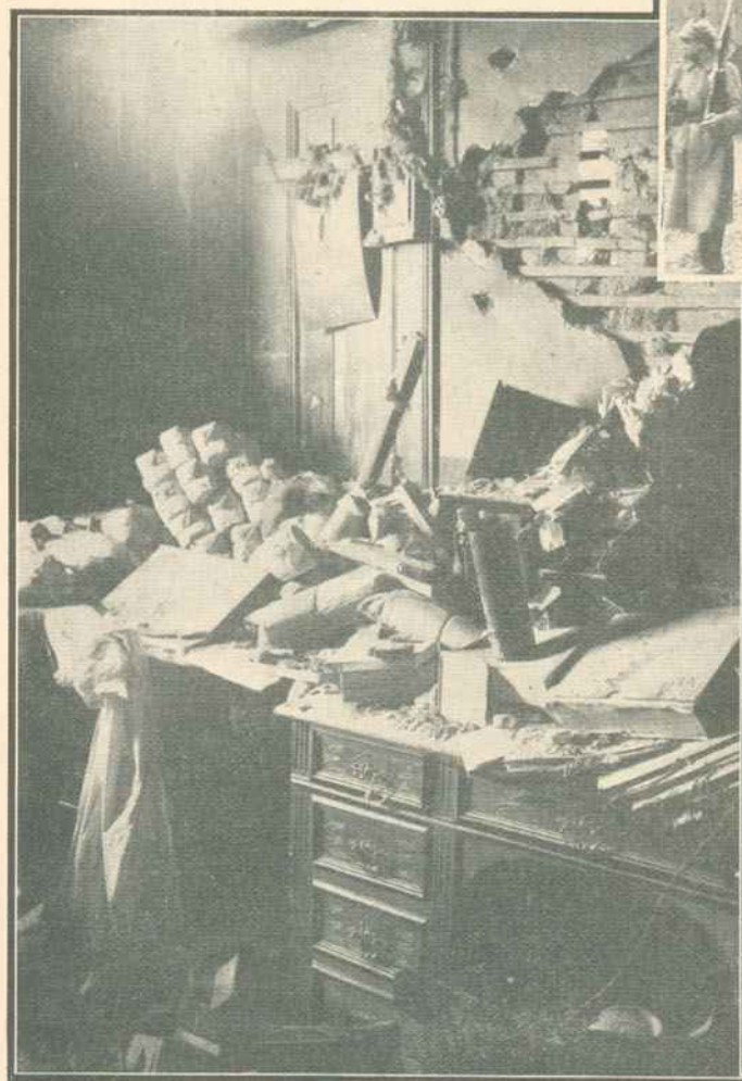
Interior de uma casa da Rua da Madalena, onde explodiu uma granada dos revoltosos
