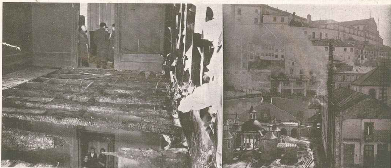
Estragos causados pelo incêndio no edifício onde está instalado o Tribunal da Relação do Porto. A nossa gravura mostra a rapidez com que as chamas lavraram, destruindo o soalho e o travejamento. — A' DIREITA: A «tourelle» da Central Telefónica de Coimbra que foi pasto das chamas, ficando a cidade sem comunicações durante algumas horas. Motivou o desastre a queda de um cabo de alta tensão sôbre uns fios telefónicos
